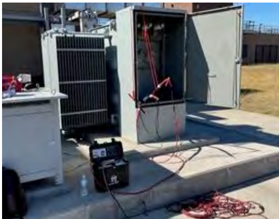
NTP TU maintenance
