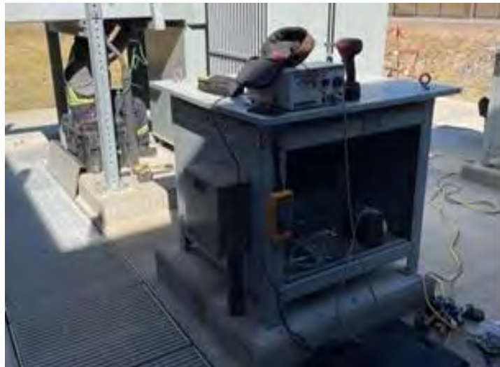
NTP TU maintenance
